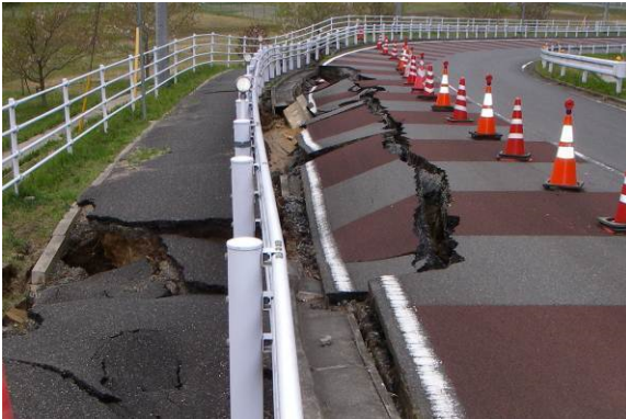
平岡地先における道路陥没
