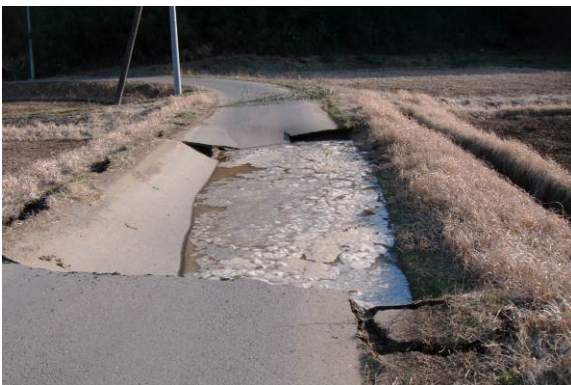
岩戸地先における道路陥没
