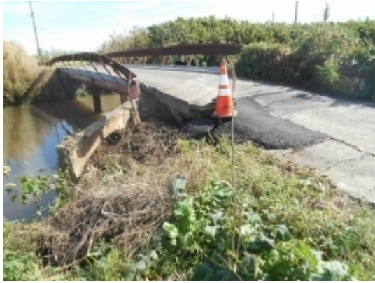
下井3号橋における道路被害
