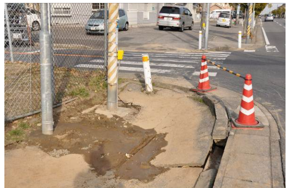
木下東交差点における液状化被害
