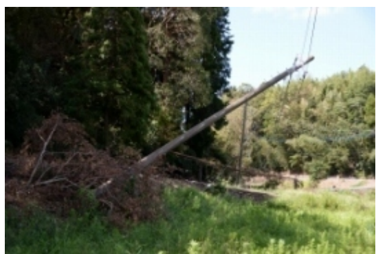
松崎地先の電柱倒壊
