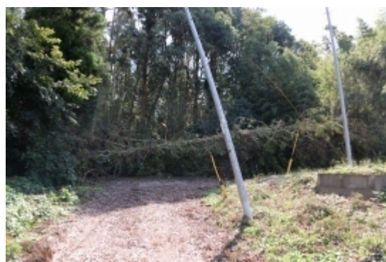
山田地先の電柱倒壊
