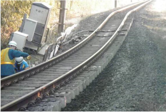
JR成田線木下駅・小林駅間における線路被害
