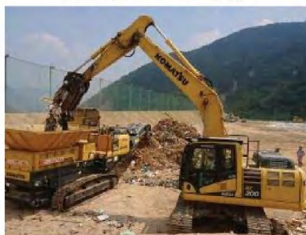
破碎機での処理 (⑥)
