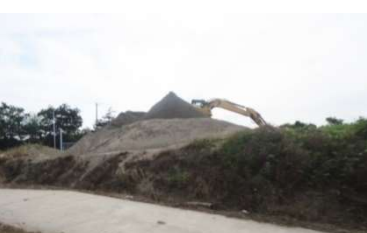
沿道側に露出している土石堆積場
