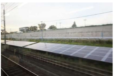
掘割部のメガソーラー
