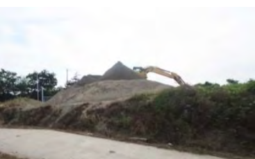
沿道側に露出している土石堆積場
