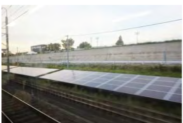
掘割部のメガソーラー
