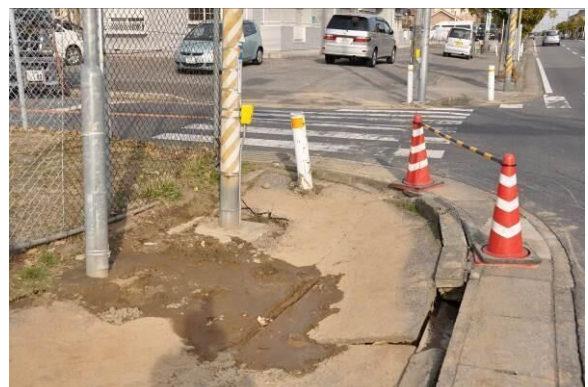
木下東交差点における液状化被害
