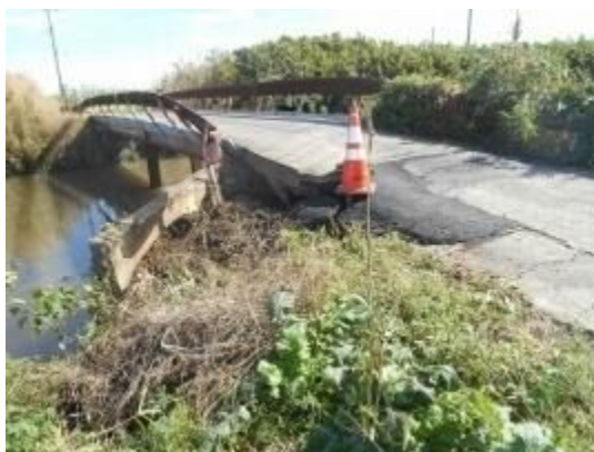
下井3号橋における道路被害
