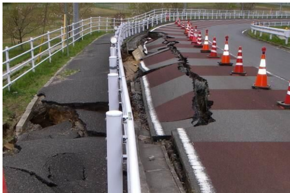
平岡地先における道路陥没
