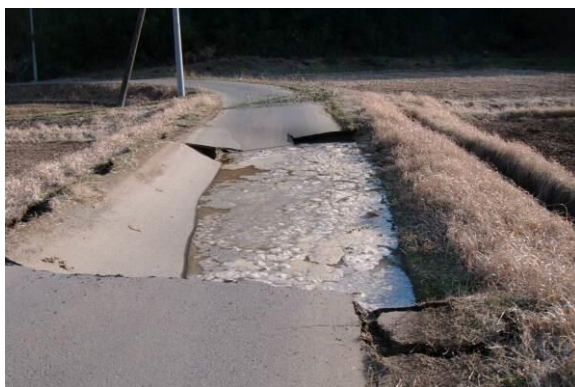
岩戸地先における道路陥没
