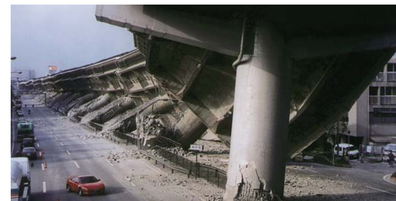
倒壊した阪神高速道路
