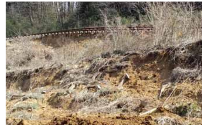
地すべりで、線路が宙づりになってしまった鹿島臨海鉄道
