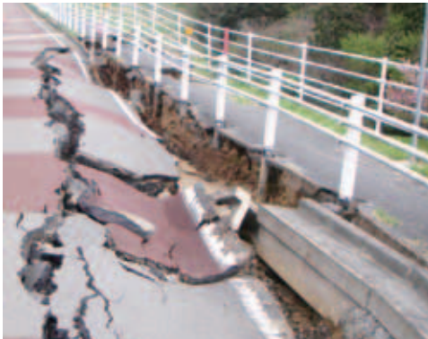
▲東京電機大学グラウンド脇の道路に刻まれた震災の爪跡(今年3月撮影)
