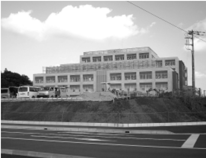
12月オープンに向け工事が進められている「印西総合病院」
