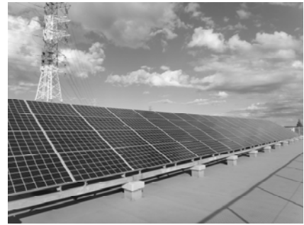
内野小学校屋上の 太陽光発電パネル
