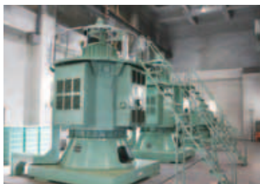
浄水場へ水を送る取水ポンプ。大きいものは高さ約 5m です
