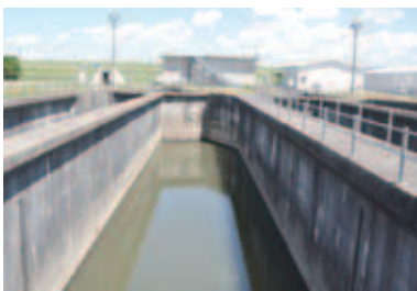
取り込んだ水は分水井(中央奥)から沈砂池(手前)に送られます
