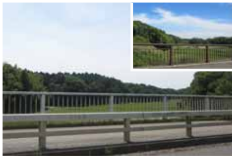
良好な谷津との調和に配慮していない色彩の防護柵
