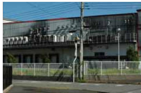
汚れや設備機器類の露出
