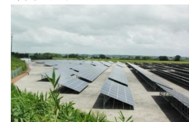
行徳の太陽光パネル
