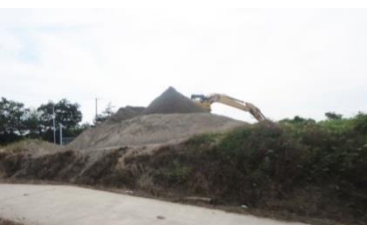
沿道側に露出している土石堆積場
