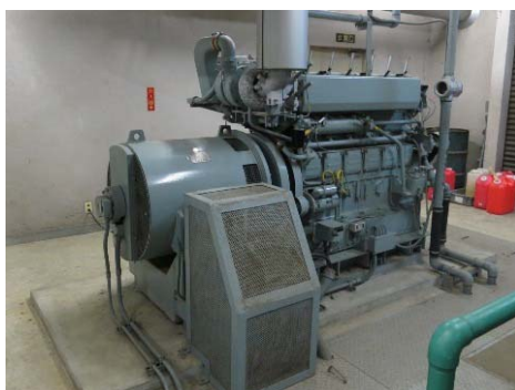
図 3-4. 自家発電設備 (平岡配水場設置 1980 年製造)
