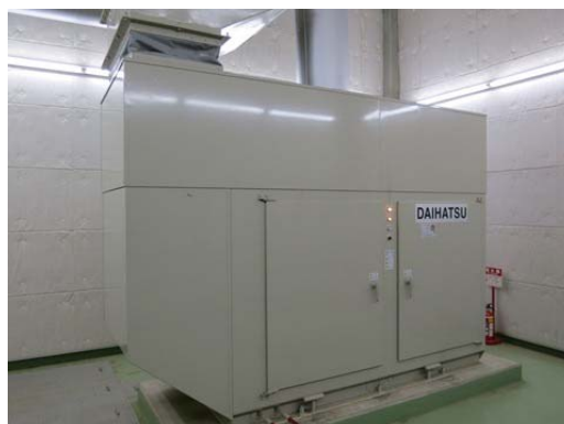
図 3-6.自家発電設備(松崎配水場)
