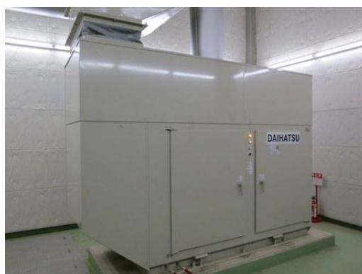
図 3-6.自家発電設備(松崎配水場)
