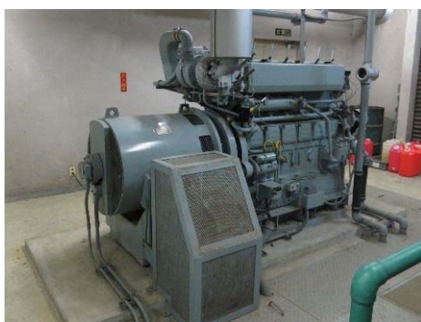
図 3-4. 自家発電設備(平岡配水場設置 1980 年製造)
