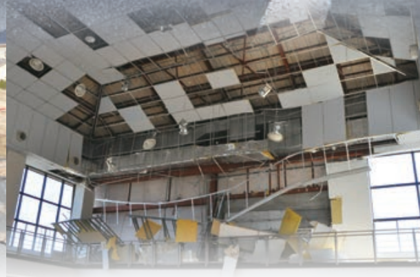
写真は東日本大震災発生時の市内の被災状況
