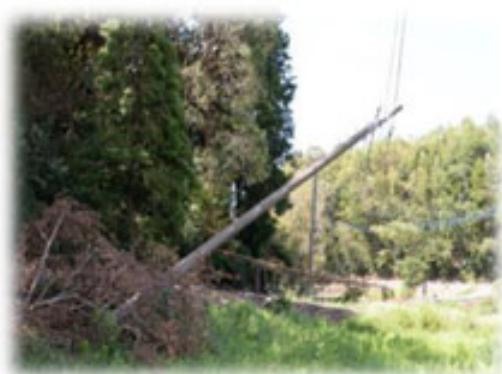
令和元年房総半島台風（台風 15 号）による 電柱の倒壊・倒木
