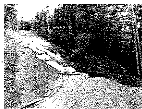
師戸地区のかけ崩れ現場。道路奥には民家の入り口が。
