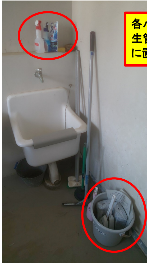
▲校庭の女子用外付けトイレ内に設置
