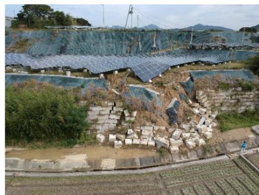
法面保護工が崩れて流出した事例
