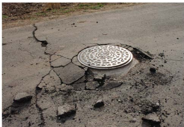
図 3-3 地震によるマンホールの突出（平岡地区）
