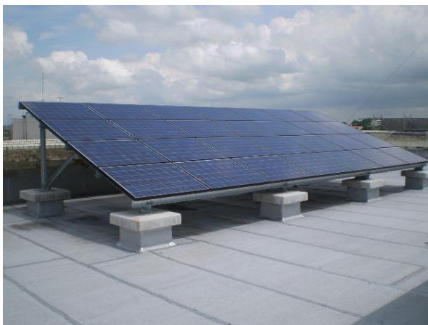
太陽光発電システム
