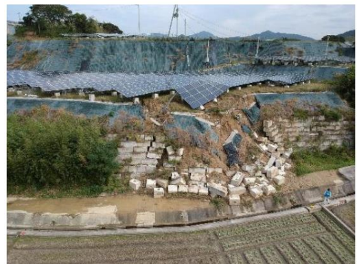
法面保護工が崩れて流出した事例
