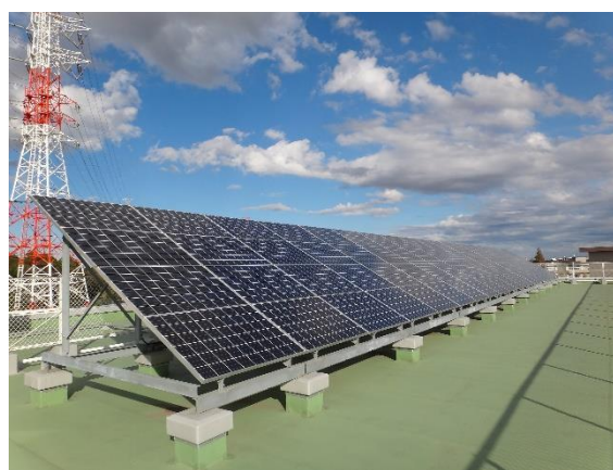
小学校屋上の太陽光発電設備
