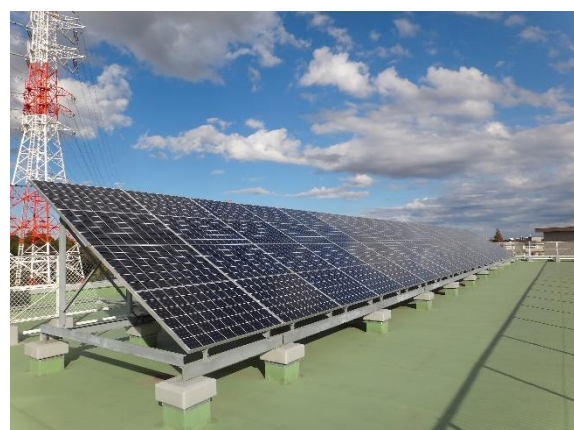
市内小学校の屋上に設置された太陽光発電設備
