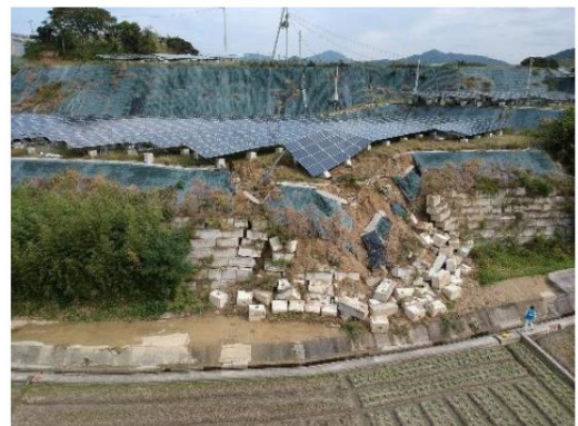
法面保護工が崩れて流出した事例
