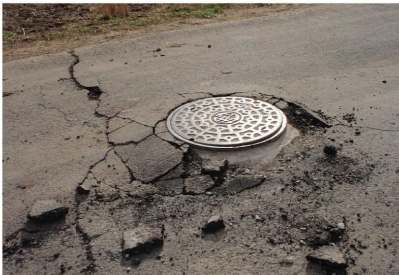
図 3-9 地震によるマンホールの突出（平岡地区）
