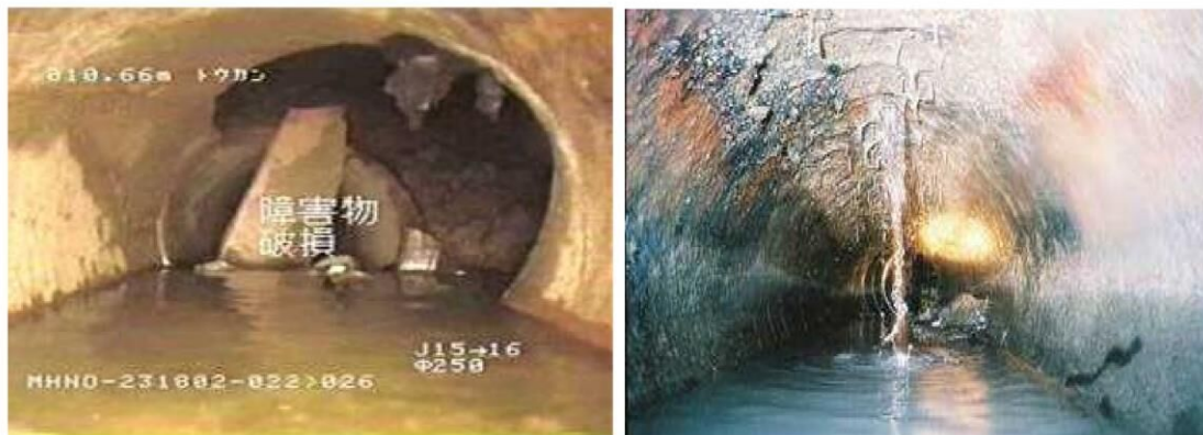
破損した管路
