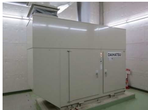
図 3-5.自家発電設備(松崎配水場)
