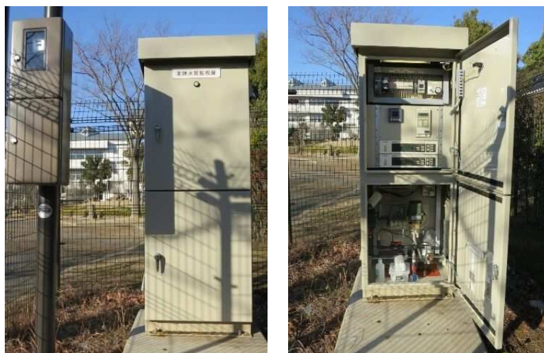
図 3-2.自動水質監視装置
