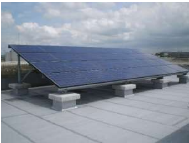
太陽光発電システム
