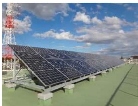
小学校屋上の太陽光発電設備
