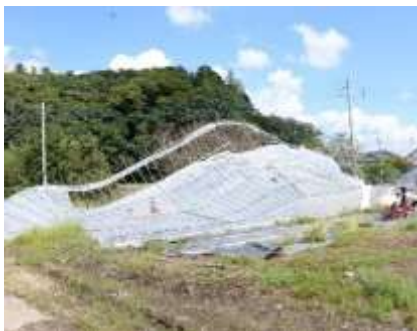
ビニールハウスの損壊
