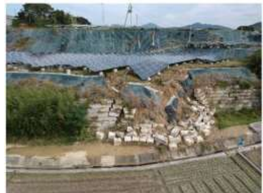
法面保護工が崩れて流出した事例
