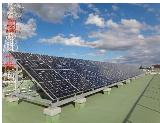
小学校屋上の太陽光発電設備
