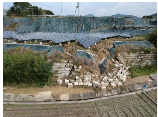
法面保護工が崩れて流出した事例
