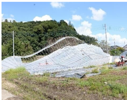
ビニールハウスの損壊
