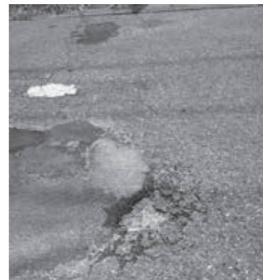
道路の穴を携帯アプリで通報可能に
