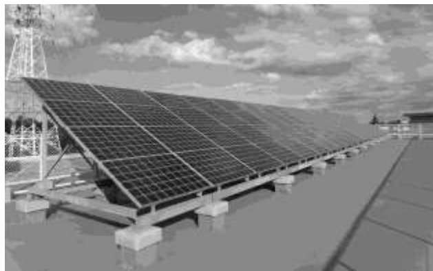
公共施設に設置された太陽光発電システム
