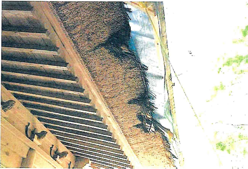
背面軒付部分の茅腐朽状況
