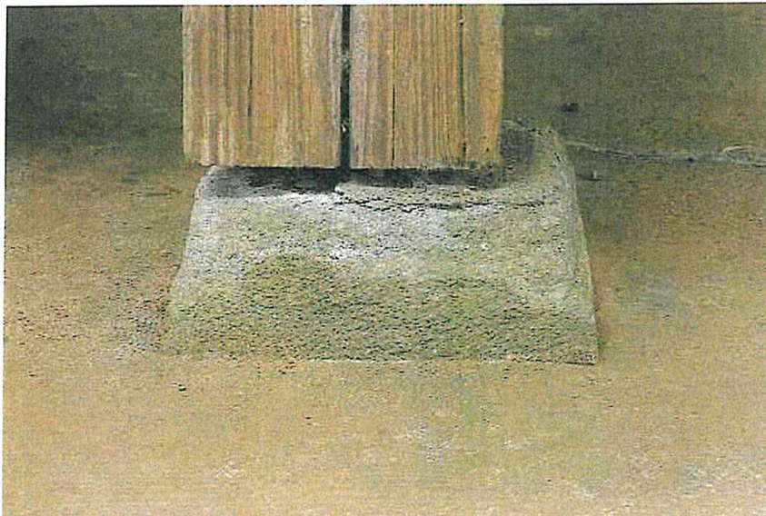
縁束石劣化状況詳細
