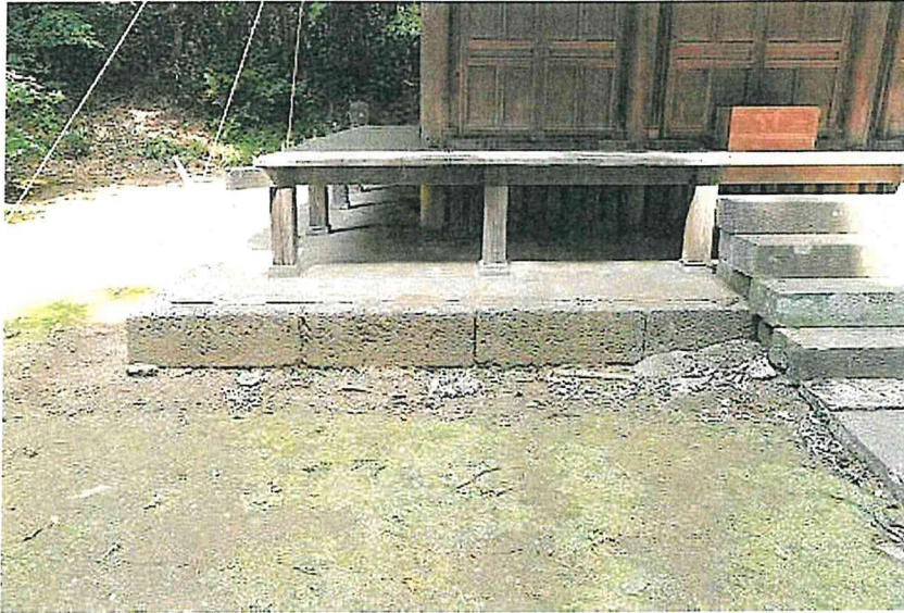
正面北側雨落の状況
