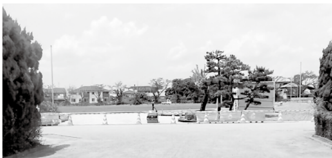
9月1日の供用開始にむけて工事が進む木下駅前にごわい広場
