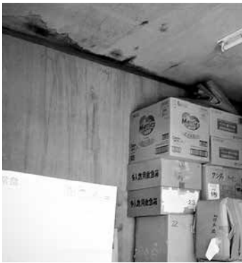
雨漏り等劣化が見られる防災倉庫
