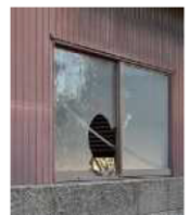
窓が割れた 管理不全空家
