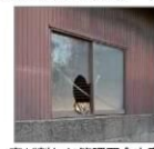
窓が割れた管理不全空家
