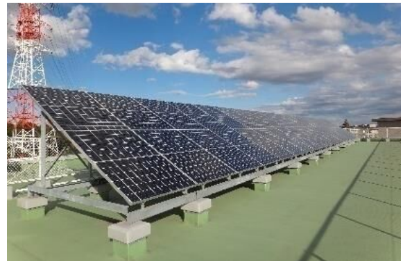
▲ 市内公共施設に設置された太陽光発電設備
