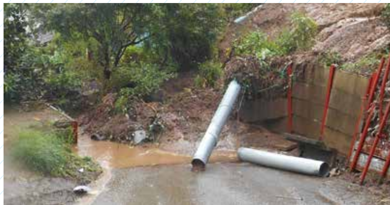
▲令和元年10月の大雨による被害(市内)
