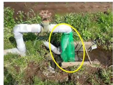
給水栓の口に被せたネット
