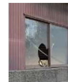
窓が割れた 管理不全空家
