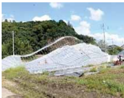
ビニールハウスの損壊
