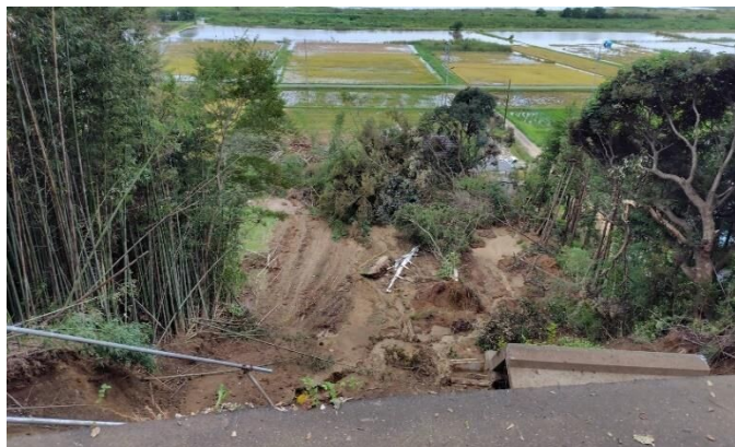
瀬戸地区の土砂崩れ
