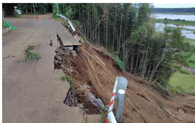
瀬戸地区の土砂崩れ
