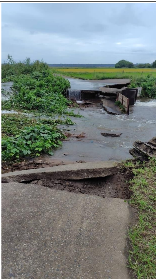
下井地区の越水により流出した市道
